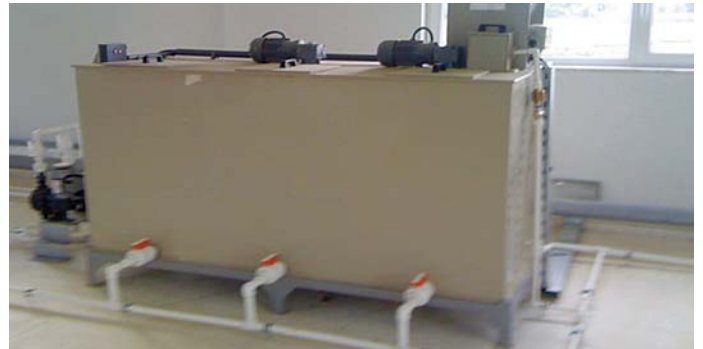
16. Chemical Material Preparing and Dosing Unit / Kimyasal Madde Hazırlama ve Dozlama Ünitesi
