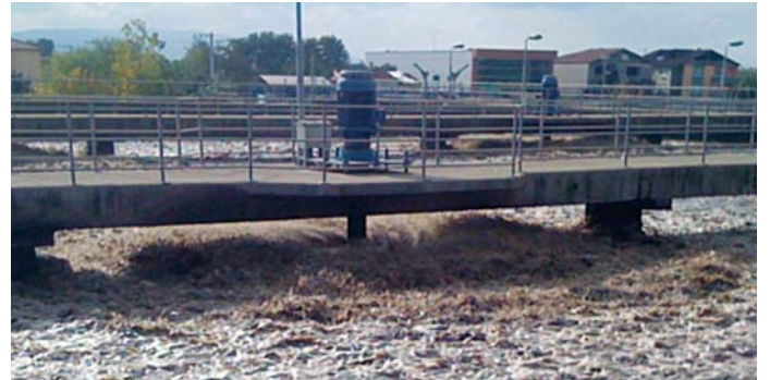
10. Fixed Floating Type Aerator/ Sabit Köprülü Aeratör
