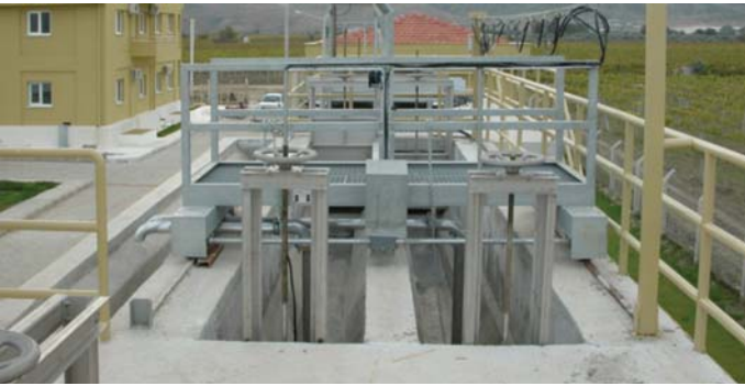
5. Sand and Oil Removal Unit / Kum ve Yağ Ayırma Ünitesi
