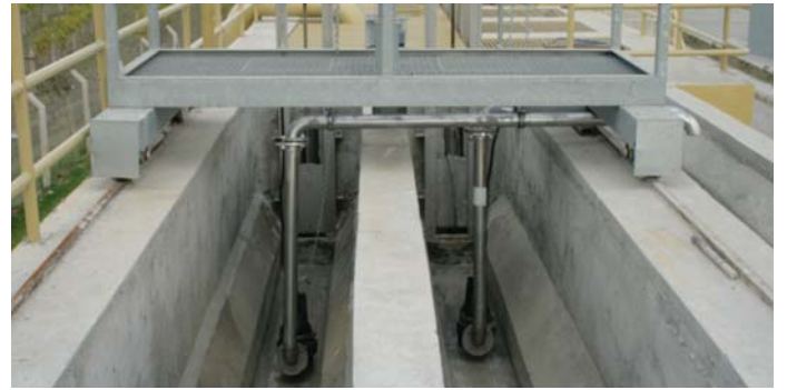
6. Sand and Oil Scraper / Kum ve Yağ Sıyırıcısı
