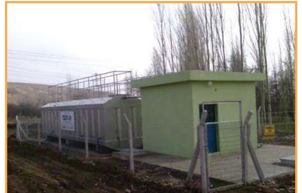
Seyitömer Termik Santrali / KÜTAHYA Seyitömer Thermal Power Plant / KÜTAHYA
