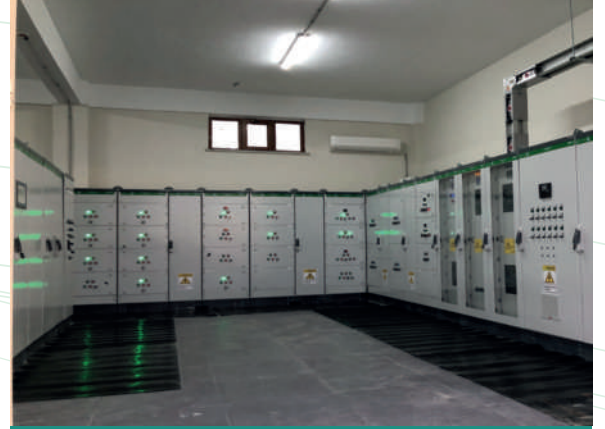
KARAPINAR (KONYA) ATIKSU ARITMA TESİSİ KARAPINAR (KONYA) WASTEWATER TREATMENT PLANT
