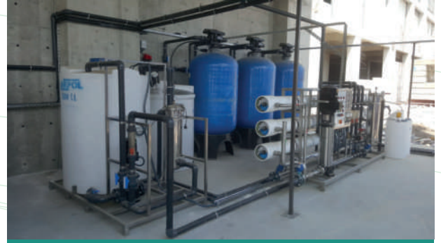
GAMA RECYCLE (DÜZCE) ULTRAFİLTRASYON TESİSİ GAMA RECYCLE (DÜZCE) ULTRAFILTRATION PLANT
