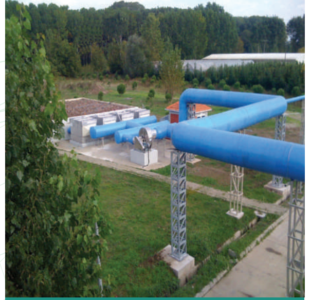
KULLAR (KOCAELİ) KOKU ARITMA TESİSİ KULLAR (KOCAELİ) ODOR TREATMENT PLANT
